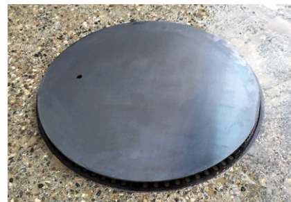
Das neue EH-Schachtabdeckblech.
